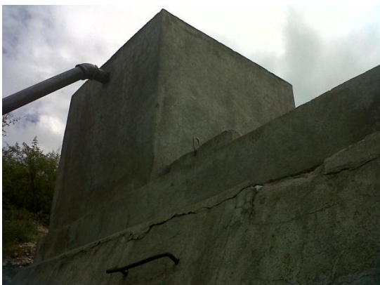
Figura 3. Tanque de distribución de agua.
